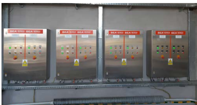
4x ovládací skříň BÜSCH vždy pro 2 elektropohony BEAservo z ušlechtilé oceli, tepelná elektrárna Žeraň, Polsko
