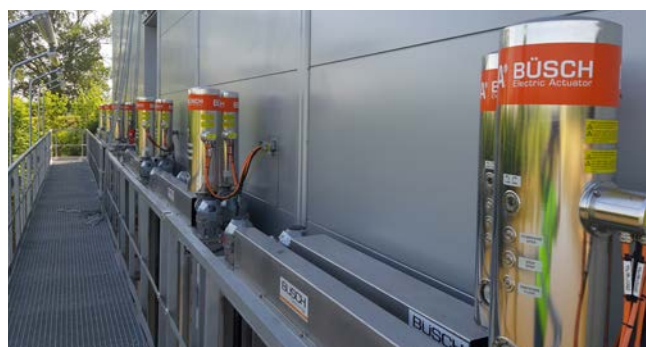
Elektropohony BÜSCH BEAservo z ušlechtilé oceli, tepelná elektrárna Žeraň, Polsko
