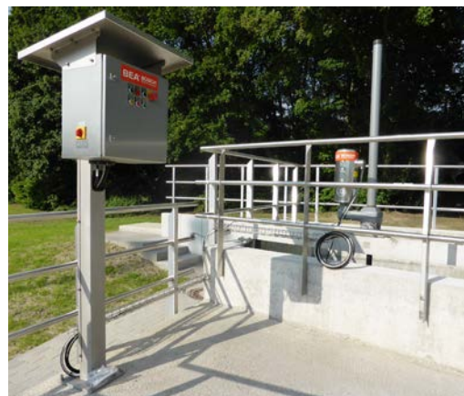
Řízení armatur BÜSCH se vzdálenou údržbou, ČOV Mannheim
