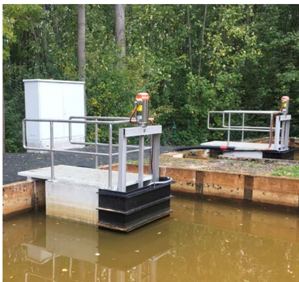
Řídicí jednotka pro armatury od firmy BÜSCH se 2 elektropohony BEAservo z ušlechtilé oceli, šoupátko s padací deskou a odvodem čisté vody, WW Naunhof
