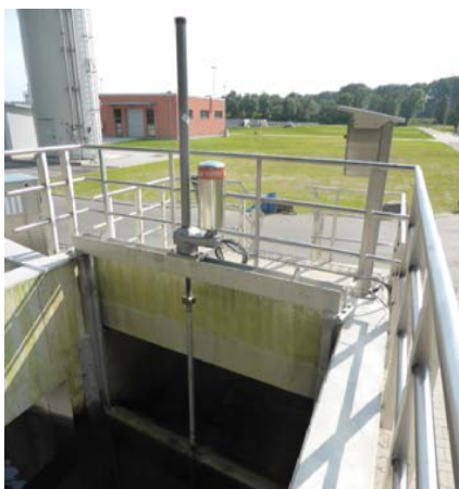
Řídicí jednotka BÜSCH s elektropohonem BEAservo z ušlechtilé oceli vč. soupátka s padací deskou, ČOV Mannheim
