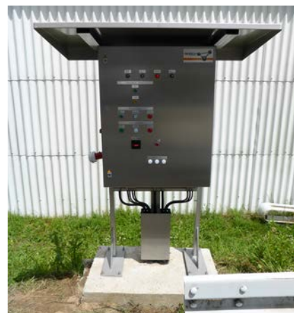
Řídicí jednotka pro armatury od firmy BÜSCH s hašení
