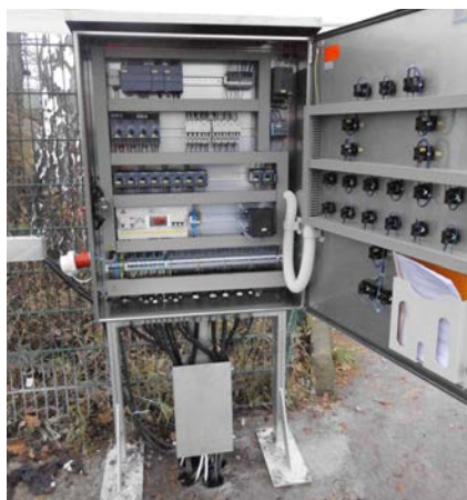
Ovládací skříň BÜSCH se zadržováním vody na
