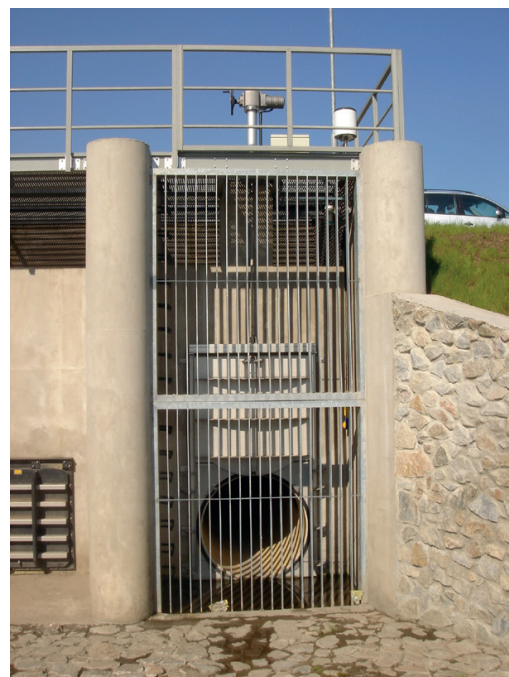
Stabrechen 1800 x 4400 mm vor Auslaufschieber
