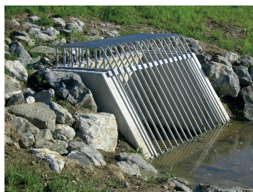
Gebogener Stabrechen an Einlaufkante
