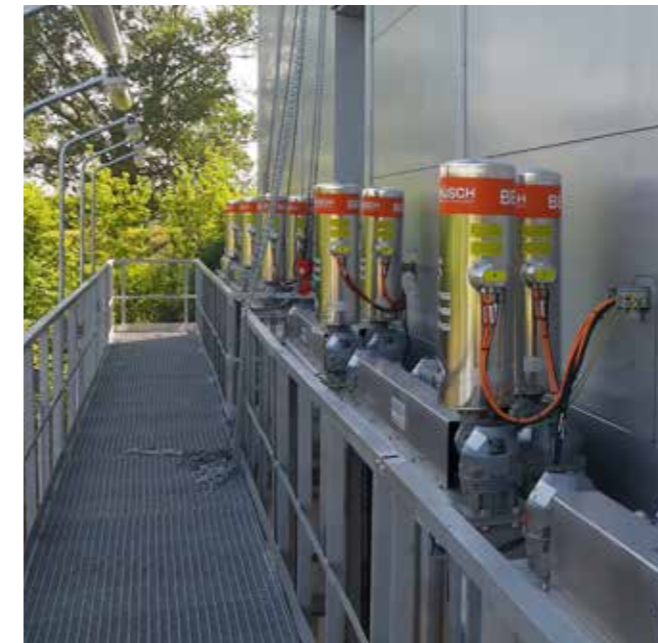
WASSERKRAFTWERK ŽERAŇ – WARSCHAU, POLEN HYDROPOWER PLANT ŽERAŇ – WARSAW, POLAND
