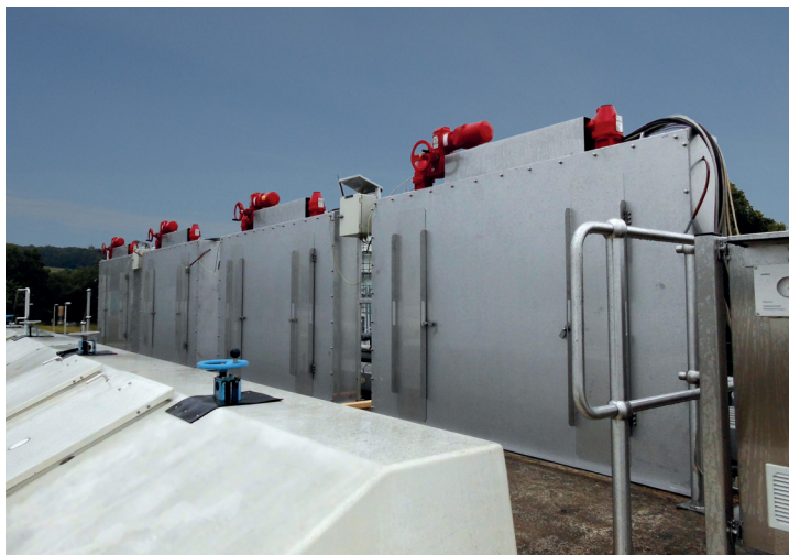
Obudowy zasuw wrzecionowych chroniące element wystające ponad komory
