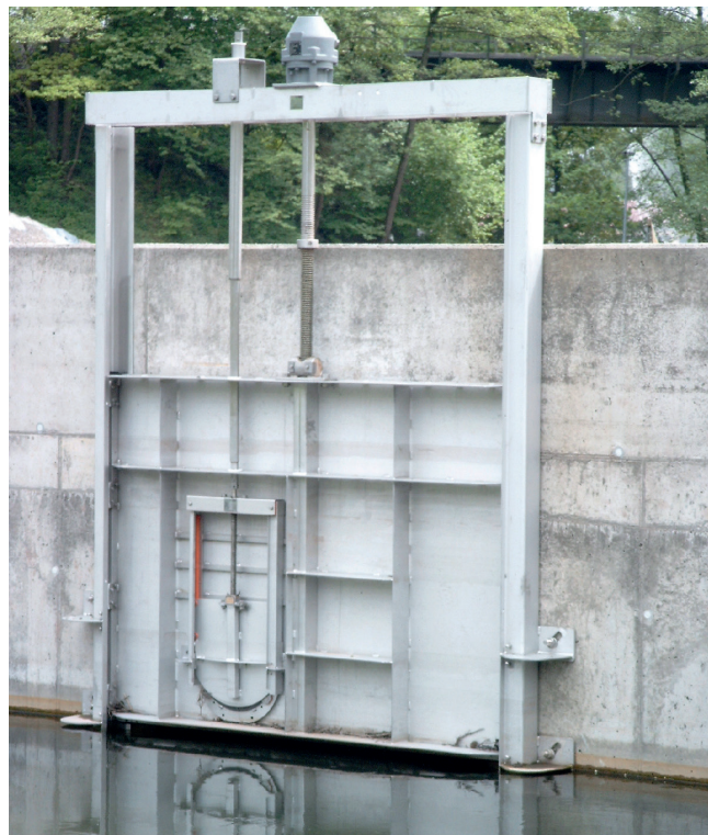
Zasuwa w systemie przeciwpowodziowym umożliwiającą pobór wody chłodzącej
