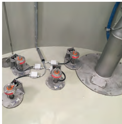
El. ukazatel z ušlechtilé oceli v úpravně pitné vody
