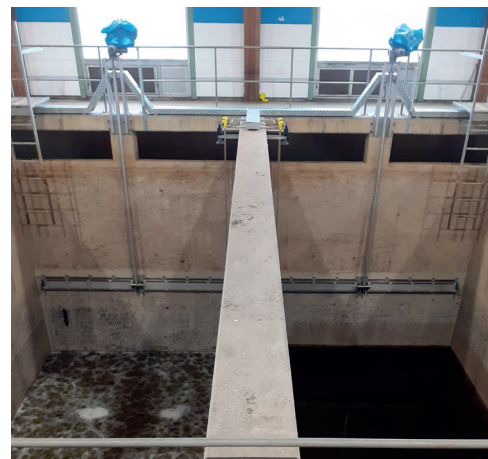
Podwójne wrota płuczące sterowane od przodu z napędem elektrycznym. Oczyszczalnie ścieków, Niemcy
